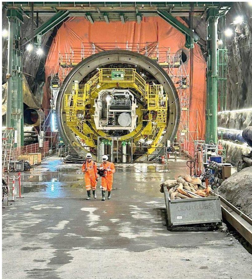
La fase di montaggio della talpa da 2.300 tonnellate che scaverà i 9 chilometri della galleria Nord
