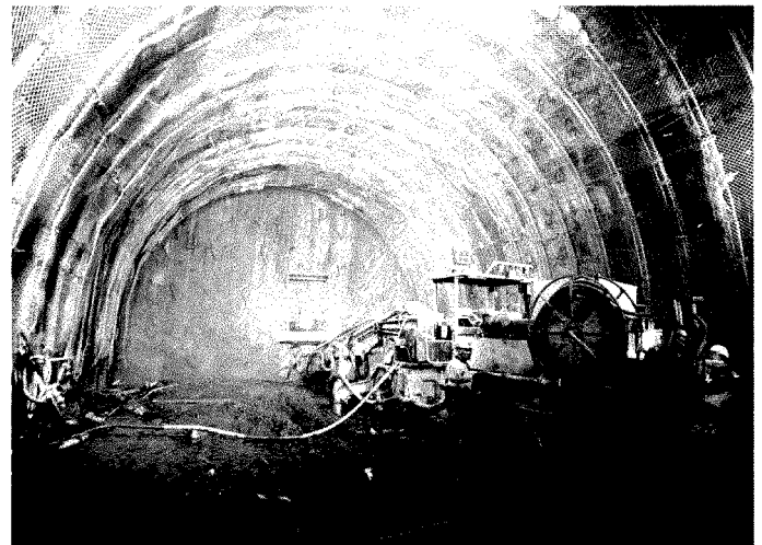
COUNTDOWN Sblocco l'iter per il tunnel geognostico di Chiomonte lungo sette chilometri e mezzo
